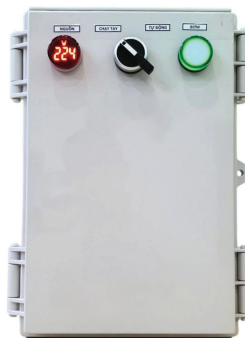
Tủ bơm nước
