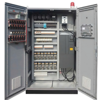
Tủ điện xử lý nước thải
