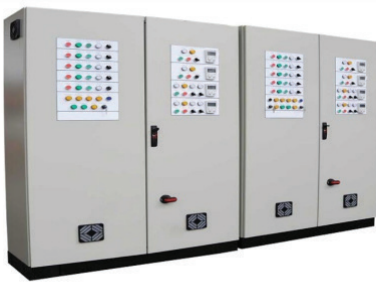
Tủ điện phân phối
