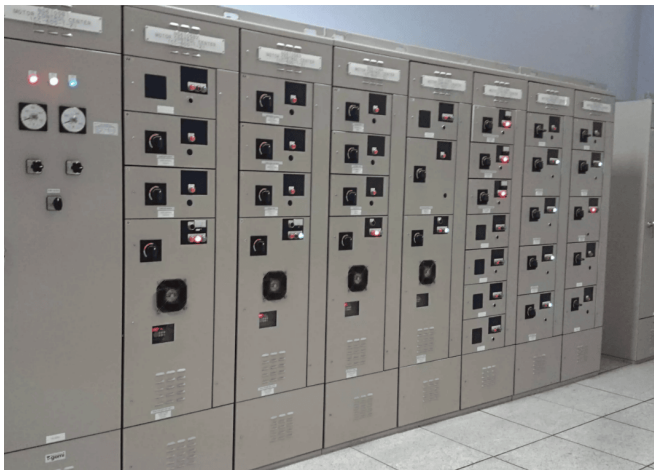
03 Dự án lắp ráp tủ điều khiển tự động hóa
