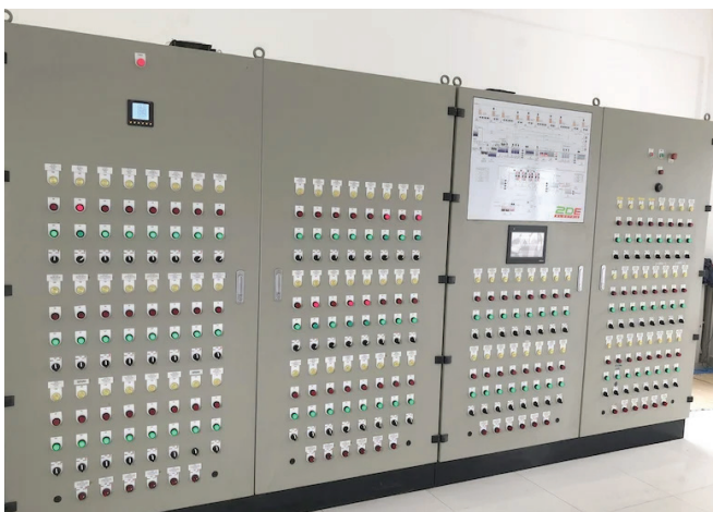
05 Dự án hệ thống điện xử lý nước thải
